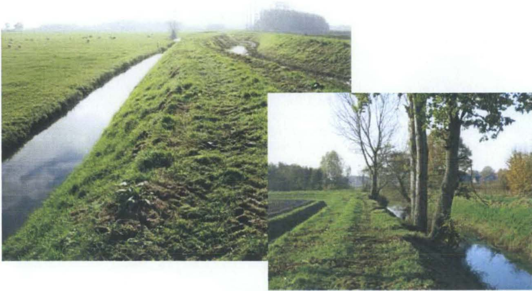
Vanaf de Hoevenseweg tot aan het uitstroompunt in de Laakse Vaart ligt de vaart tussen kades. Het aanliggende land ligt vaak lager dan de kades. Hier en daar staan solitaire bomen op de kade
